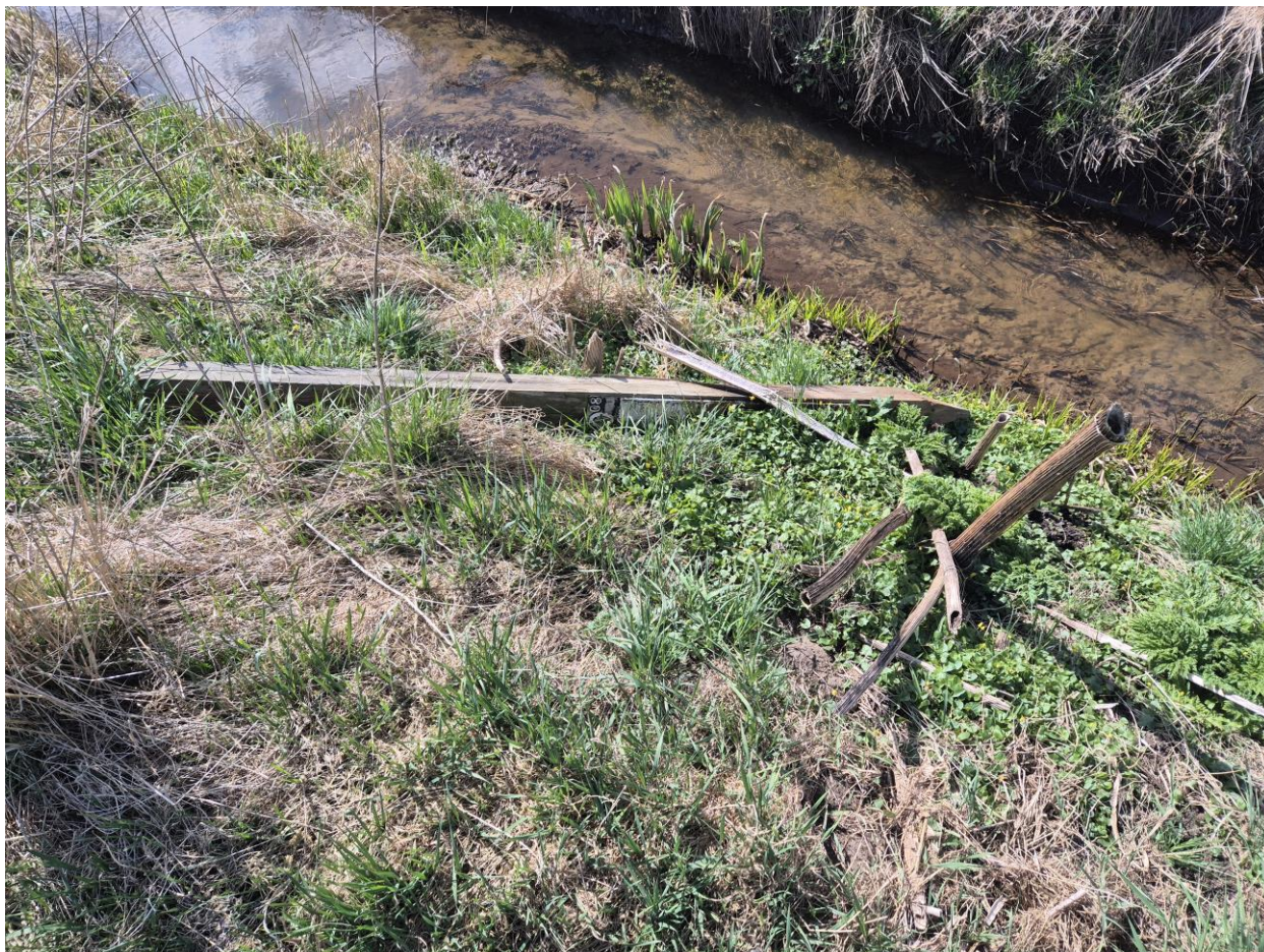
Figur 20 Station 78. Beskadiget skalapæl.
