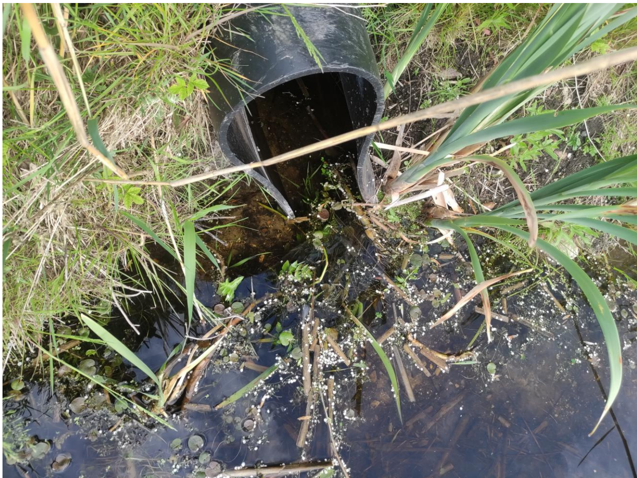
Figur 12 Station 861. Deformt rørindløb.
